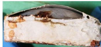
写真-1 環境遮断シート剥離箇所
