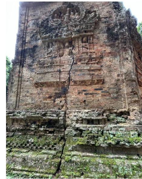
縦に入った亀裂
