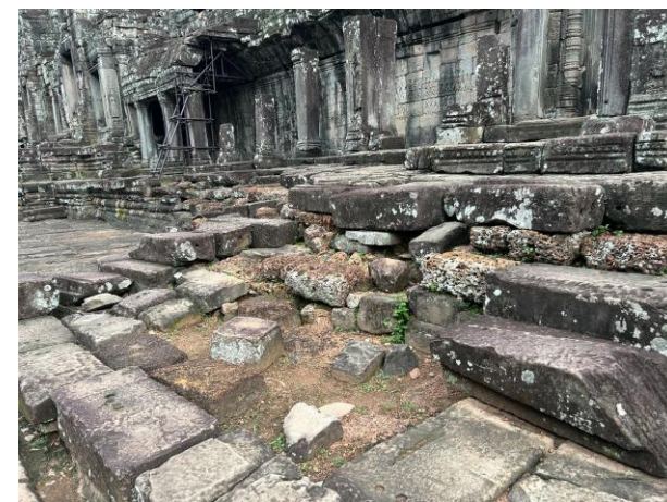
石積みが崩壊し、基壇盛土が露出している
